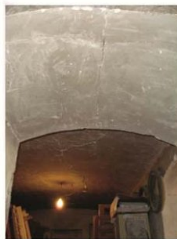
تصویر ۱۰: ایجاد ترک در پوشش زیرزمین - بهمن ۱۳۸۸
