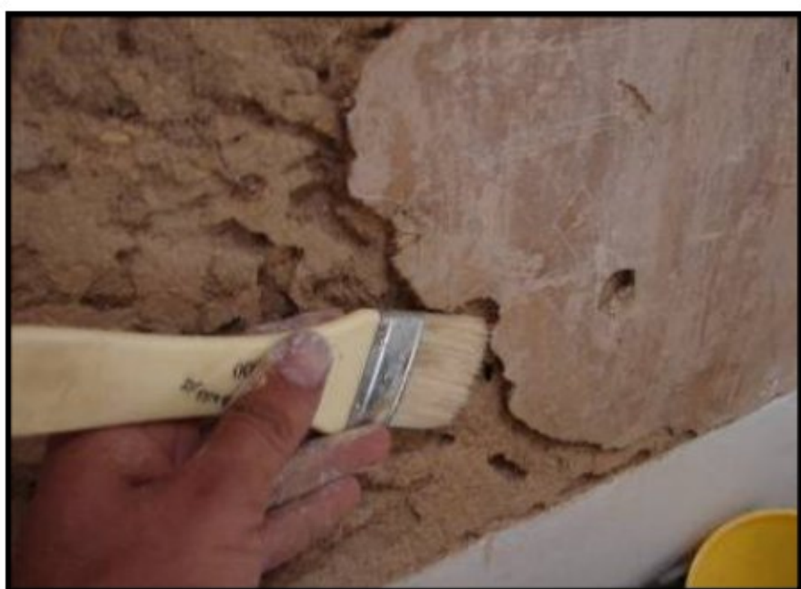
شکل ۲۵. تخریب لایه آستر توسط موریانه و جدا شدن بستر
